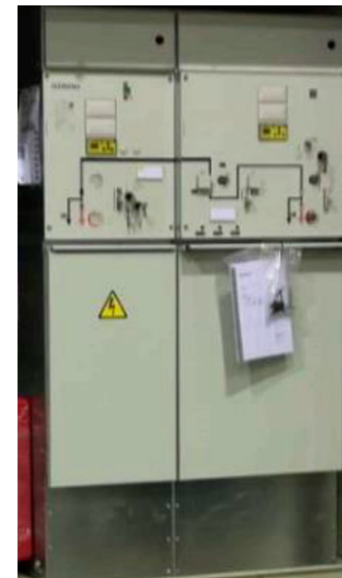
Conj. Línea + protección Int. Automát.
