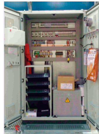
Cuadro de SSAA Con transformador de SSAA y SAI
