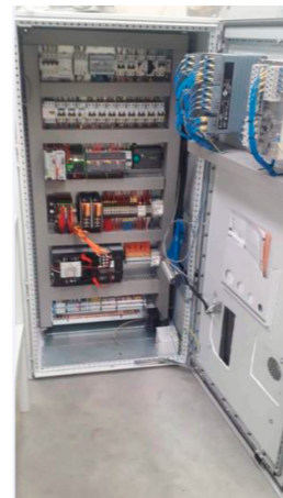
Cuadro de SSAA con comunicaciones + relés de protección
