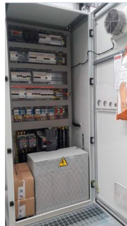
Cuadro de SSAA Con transformador de SSAA
